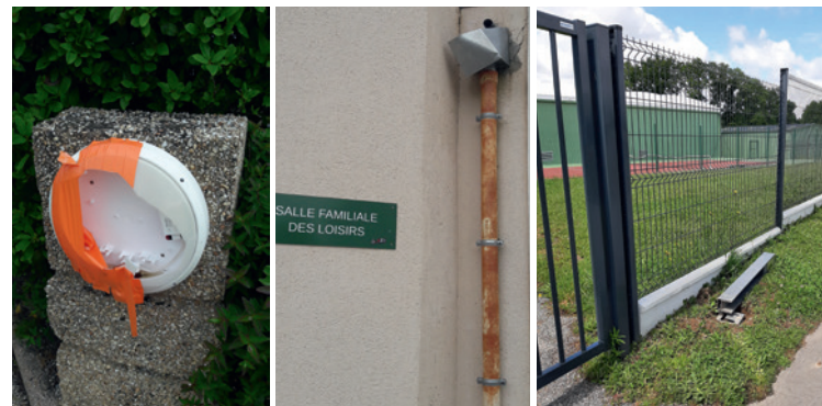
Éclairage et gouttière - Salle Familiale des Loisirs
